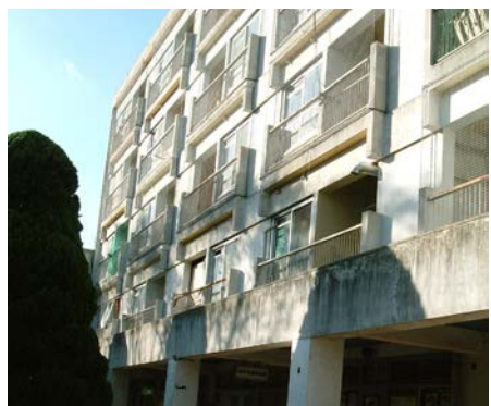
図 9. 空き家が目立つ住棟
