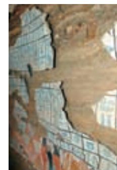
埋葬室東面 波打つプラスター
