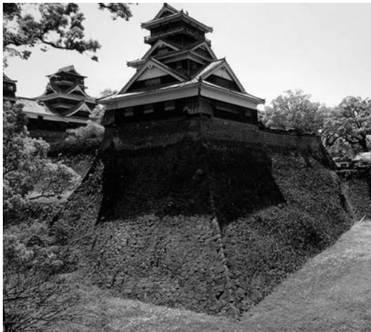
図 4 宇土櫓の被災状況
