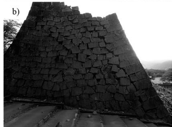
図8 二ノ丸御門の被災状況, a) 全貌, b) 崩壊箇所の東側の側面.
