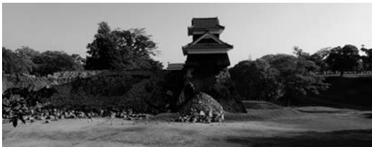
図 3 戊亥櫓の被災状況
