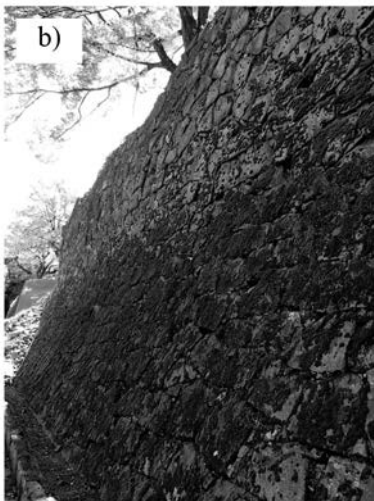
図7 百間石垣の被災状況, a) 崩壊箇所, b) 崩壊を免れた箇所.
