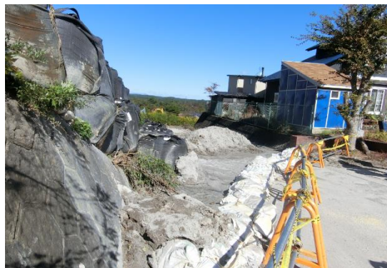
写真2 西郷村内の土砂流出現場
