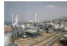
大規模プラントの配管
