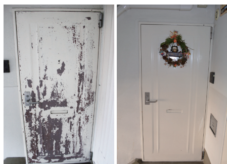
写真1: 玄関扉の表出と老朽化
